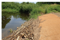
Restauration des berges du Boublon au Moulin Pointu (technique mixte et fascine)
