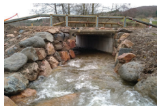
Remplacement d'une buse par un pont cadre sur la Bouble à Teilhaet
