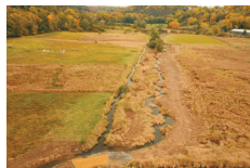
Reméandrage (860 ml) et installation de banquettes végétalisées (200 m) sur le ruisseau de Mazaye à St-Pierre-le-Chastel
