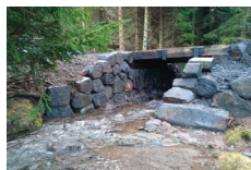
Remplacement d'une buse par un pont en bois sur le Chevalard au domaine de Passade
